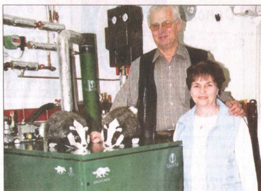
Günter und Christa Lenk aus Clausthal-Zellerfeld erzeugen mit ihrem Mikro-Blockheizkraftwerk namens Dachs Strom – auch fürs öffentliche Netz.
