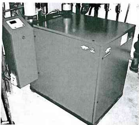
Nicht größer als ein Öl- oder Gasheizkessel ist das Mini-Blockheizkraftwerk, das neben Heizwärme auch ausreichend Strom für die Bewohner des Mehrfamilienhauses erzeugt
