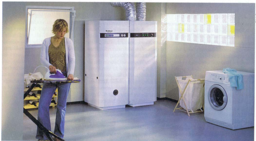
Beim Installieren genau auf die Jahresarbeitszahl achten: Wärmepumpe von Buderus
