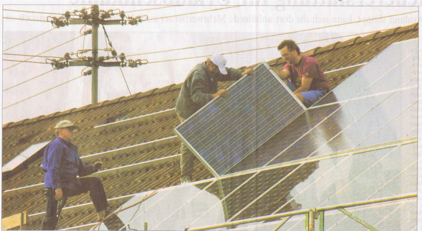
Immer mehr Bundesbürger rüsten ihre Dächer auf. Allein 2006 wurden 40 000 Solaranlagen auf Privathäusern installiert
