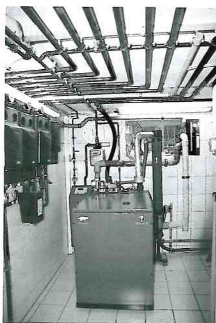
Die Heizkraftanlage vom Typ Dachs ist im Keller des Hauses untergebracht.
