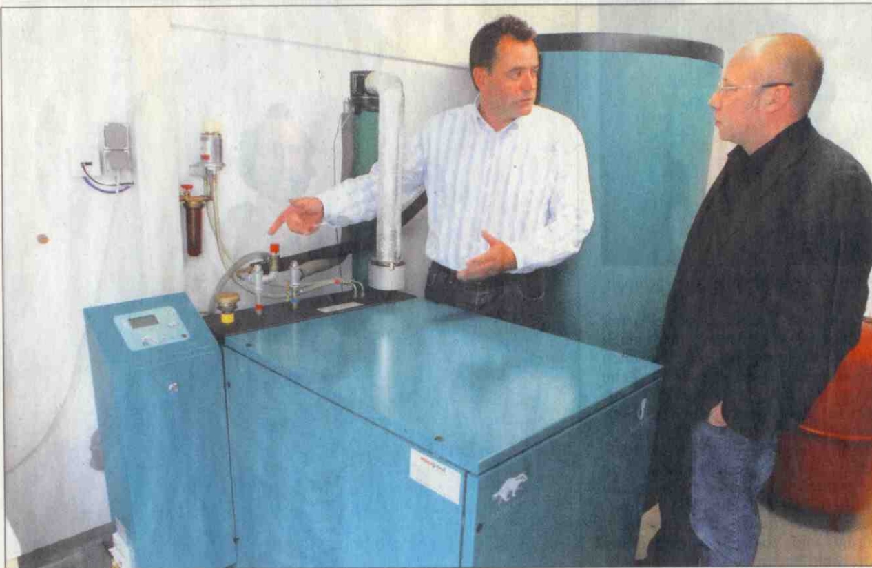
So sehen sie aus, die Mini-Blockheizkraftwerke, die Matthias Scholz (rechts) und Thomas Bandekow in Kellern und Garagen montieren. Foto: Rudolf Flentje
