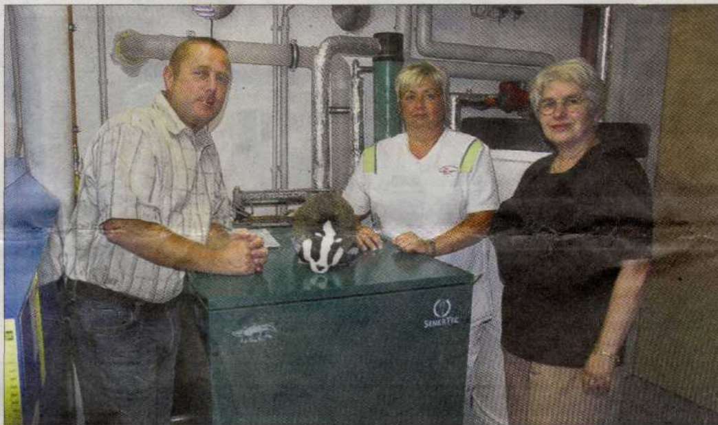
Es ist seit einigen Tagen in Betrieb: das Mini-BHKW im Keller des DRK-Seniorenzentrums. Fachmann Peter Miesner (li.) mit Gabi Werner (Mitte) und Margrid Stark. Foto: Simone Pötschke
